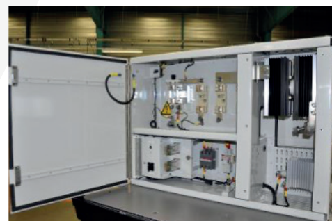
Armoire électrique secteur ferroviaire
