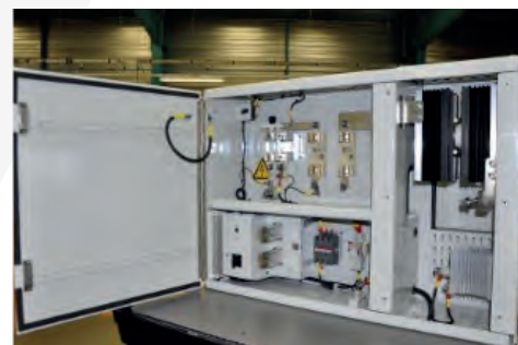
Armoire électrique secteur ferroviaire
