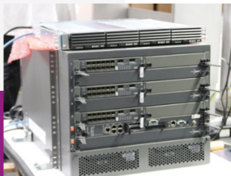
Contrôle et test de la baie informatique
